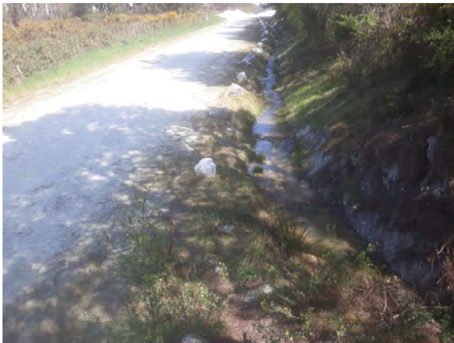
Arrivée d'eau depuis le site de la carrière
